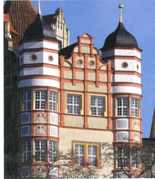
Wiederholt im Einsatz war die Bauhütte auch am Schloss Bernburg, darunter 2017 am Runderker. Referenzfotos: Firma
